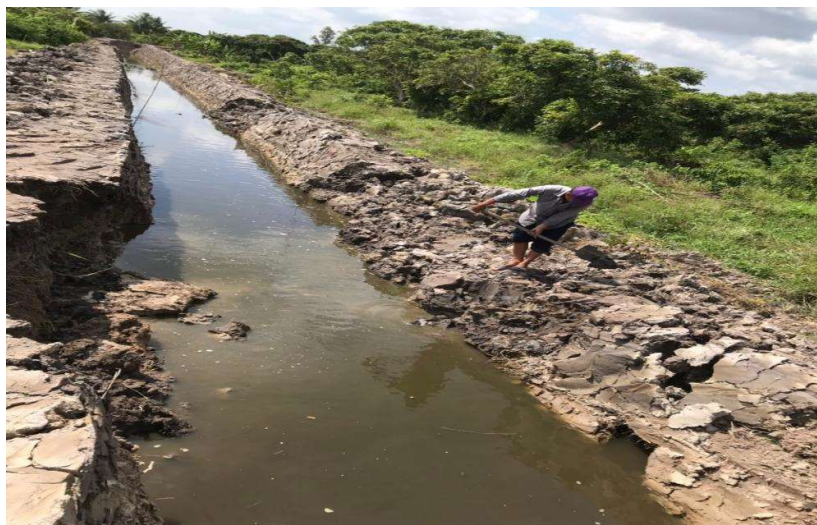
Hình 3-55 Công nhân đắp lè đất những chỗ bị sạt lở
