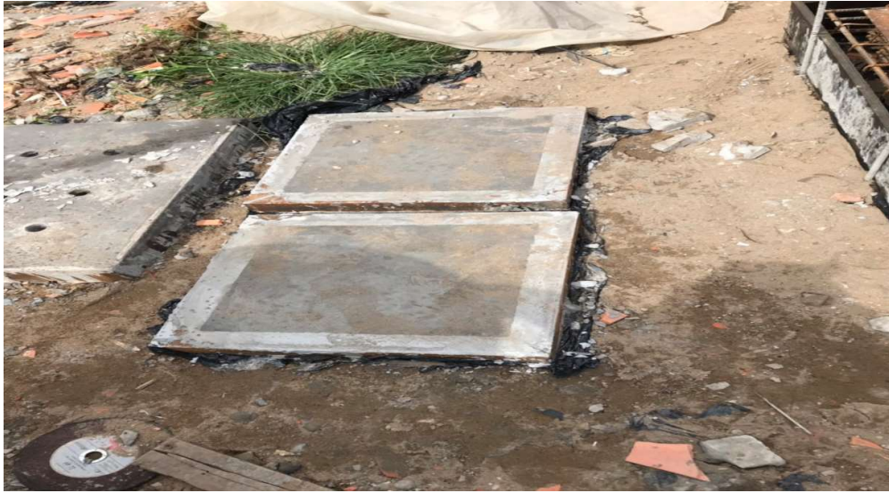
Hình 3-16 Nắp đan hồ ga thoát nước sinh hoạt
