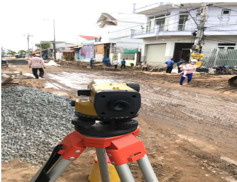
Hình 3-39 Đo làm dấu cao độ hoàn thiện hố ga thoát nước sinh hoạt
